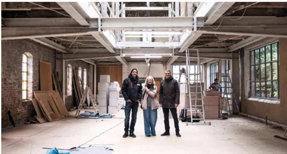
Bauleiter Philipp Oerke, Paula von Sydow (Kulturbüro) und Holger Denckmann (Dezernent für Kultur, Schule, Sport und Gebäudewirtschaft) geben Einblick in den Sanierungsfortschritt
