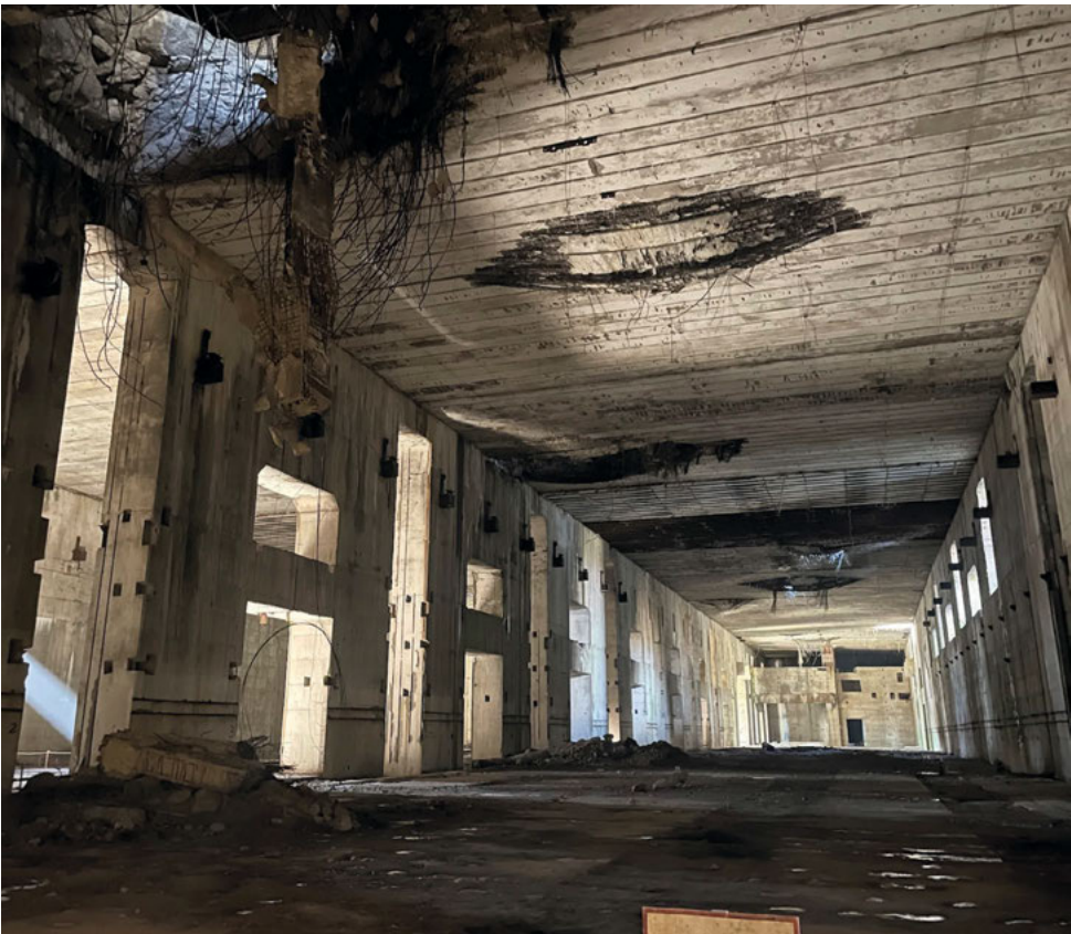
Die Einschläge der Bomben der Royal Air Force sind heute noch im „Bunker Valentin“ sichtbar
